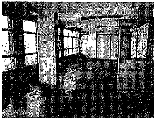
FOTO 21: 20º PAVTO | Sala
